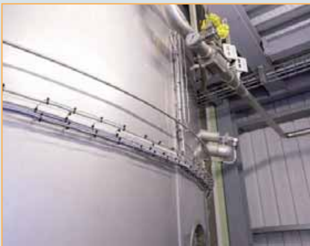
An Kessel- und Siloanlagen
